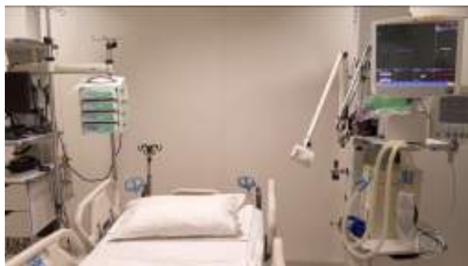
Imagem 20 - Unidade de Tratamento Intensivo pronta para receber pacientes.
